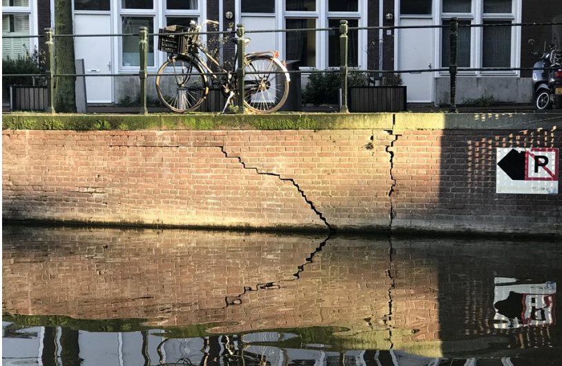
Figuur 4-4 - Voorbeeld van scheuren in een kade
