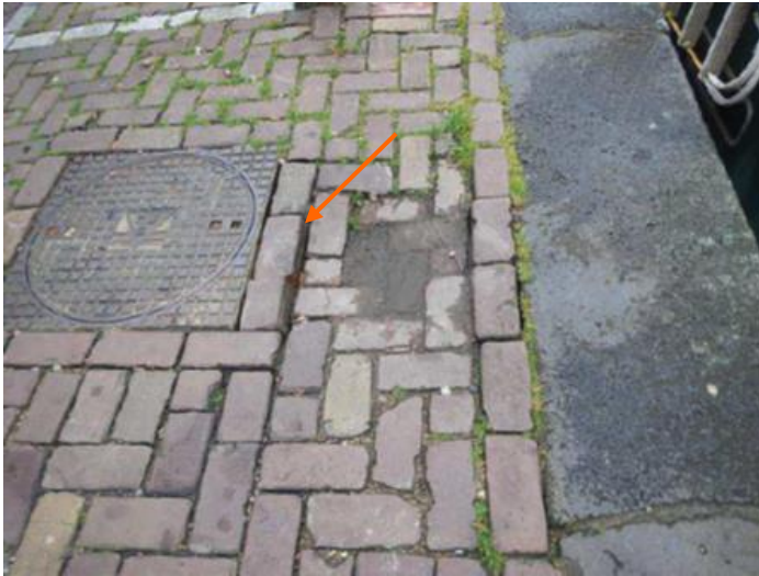
Figuur 4-7 - Openstaande voegen van de bestrating in zone 1
